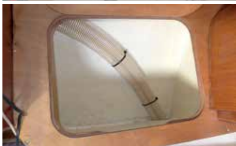
Las mangueras de llenado ¡¡estaban laminadas al casco!! en su paso por uno de los cofres. No hubo más remedio que afrontar el problema con el formón y la sierra plana. En la nueva instalación dejamos las mangueras a la vista, debidamente embriadas por estética y seguridad
