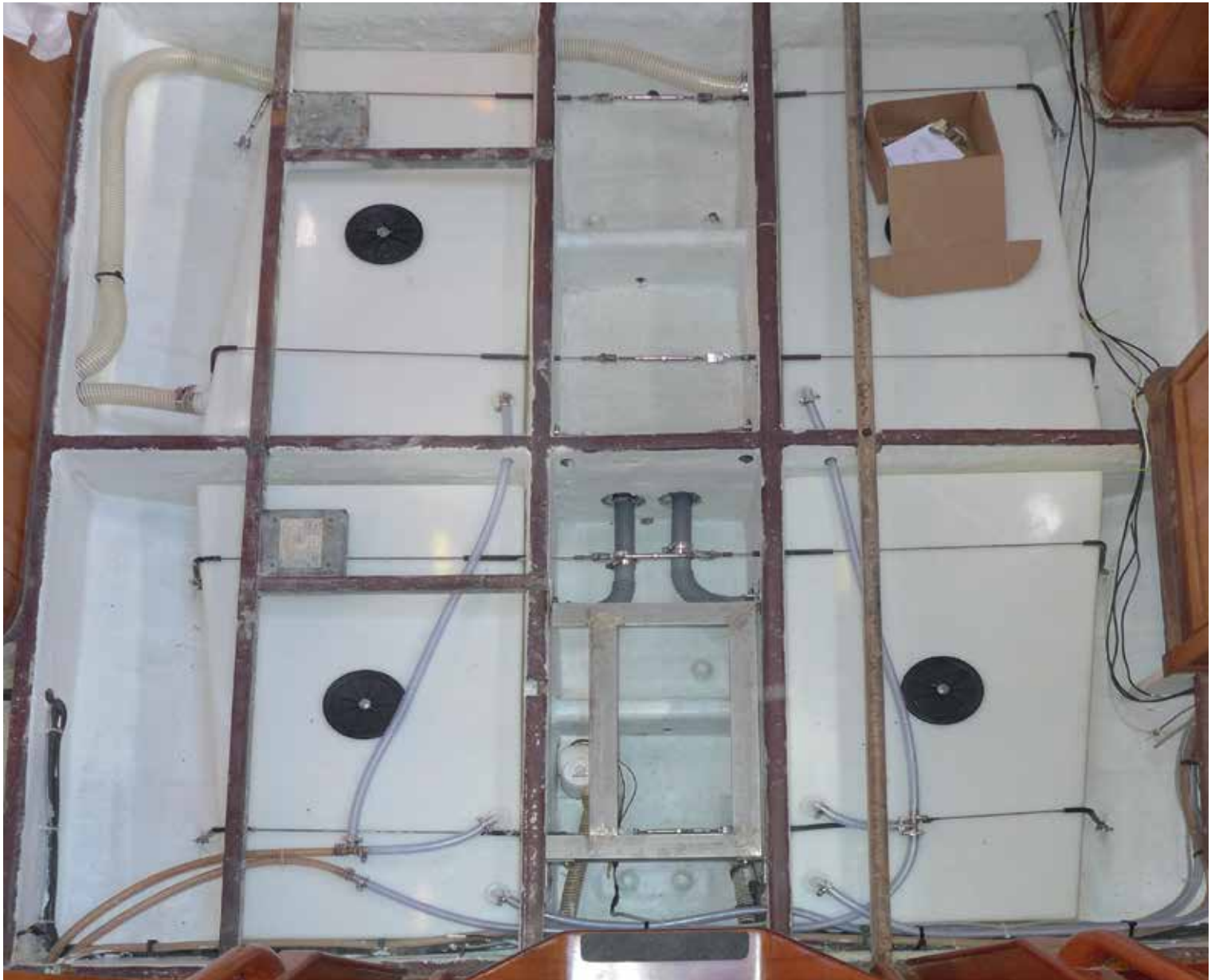
Las sentinas son la mejor ubicación para los depósitos en cuanto a reparto de pesos, pero la más incómoda de cara a su mantenimiento
